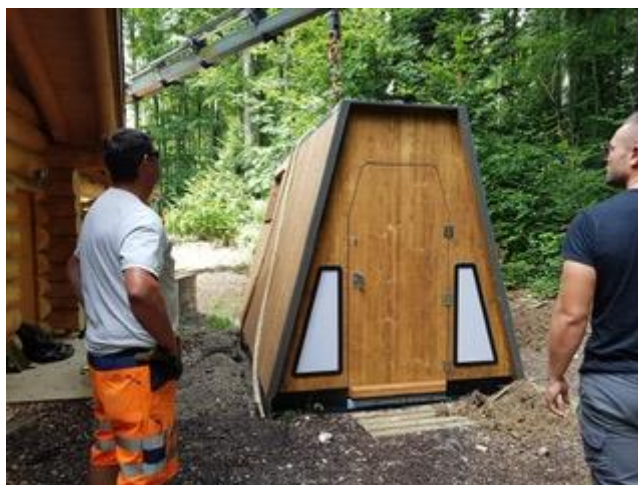
Toilettes sèches du refuge
